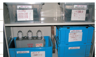
PCBを含むコンデンサ類保管庫
